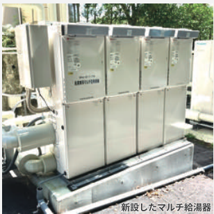
新設したマルチ給湯器
